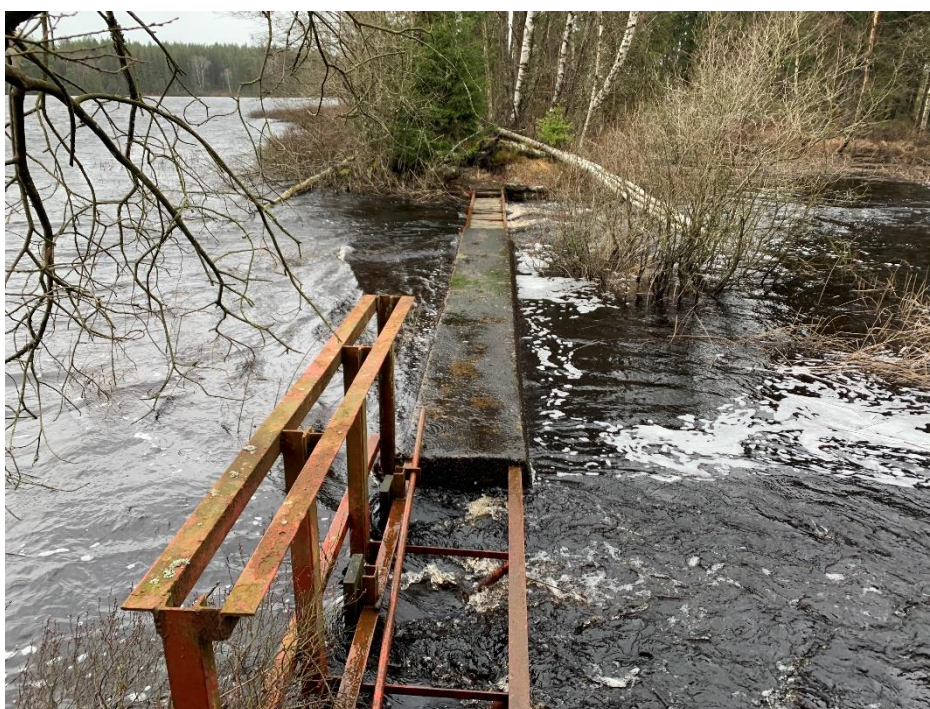
Figur 4. Dambyggnaden med utskov i förgrunden och skibordsöverfall i bakgrunden, vy från höger strand.
